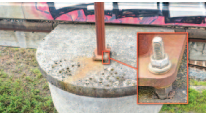
Kørestrømsmast monteret på bropille
